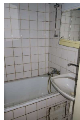
Koupelna domu č.p. 140
