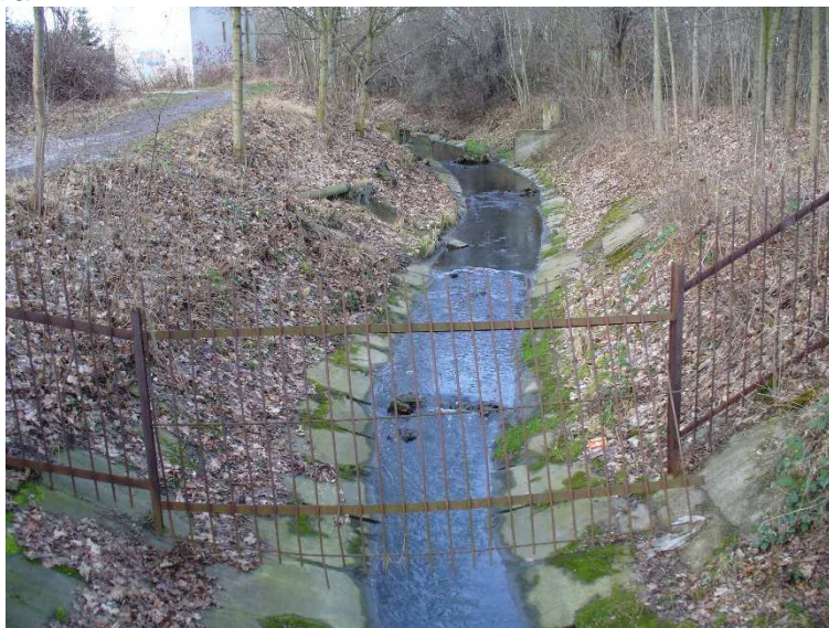
obr. 16 – úsek 07, pohled proti proudu, zarostlý opevněný úsek
